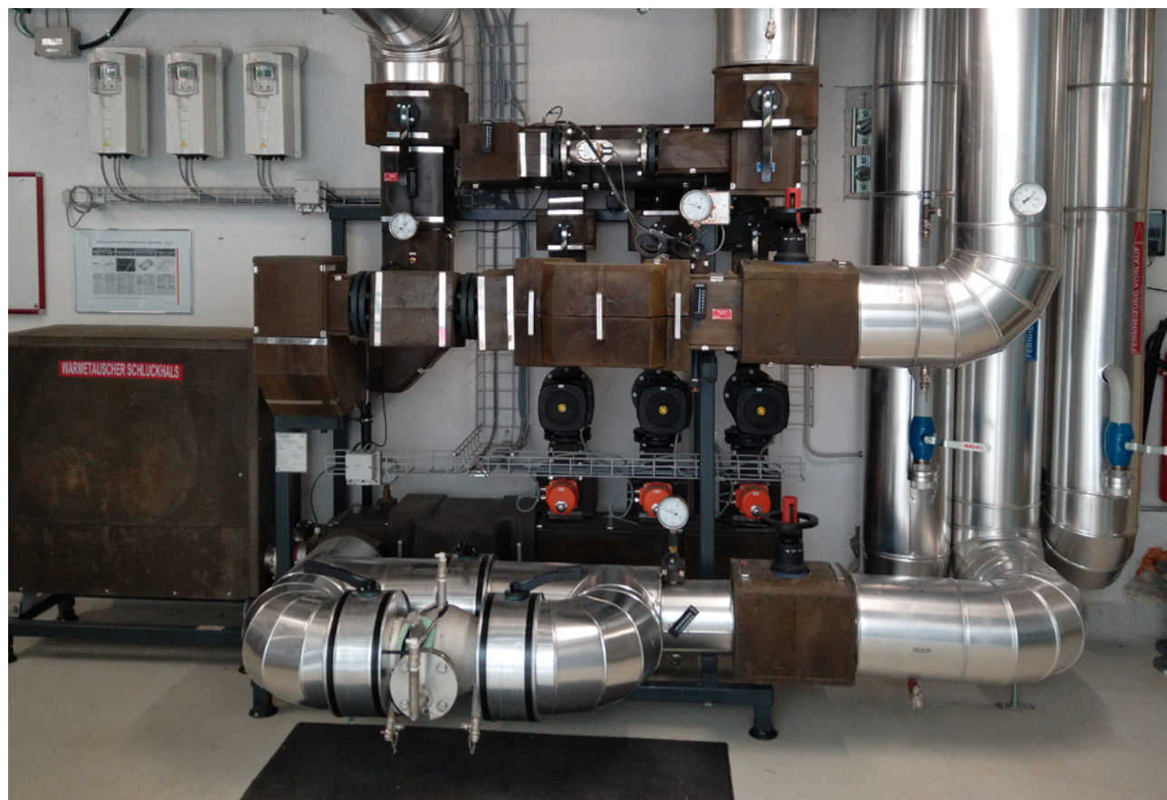
Heizzentrale Spiez im Solina
